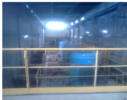
Local des pompes
