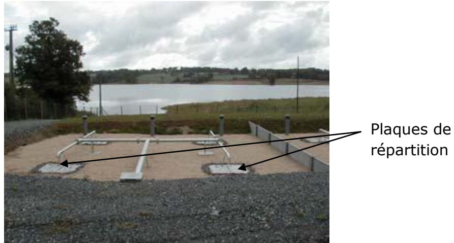
Photo 14 : Répartiteur par rampe d'implantation
