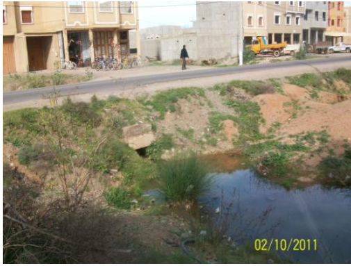
Photo 8 : Drainage des eaux pluviales naturel
