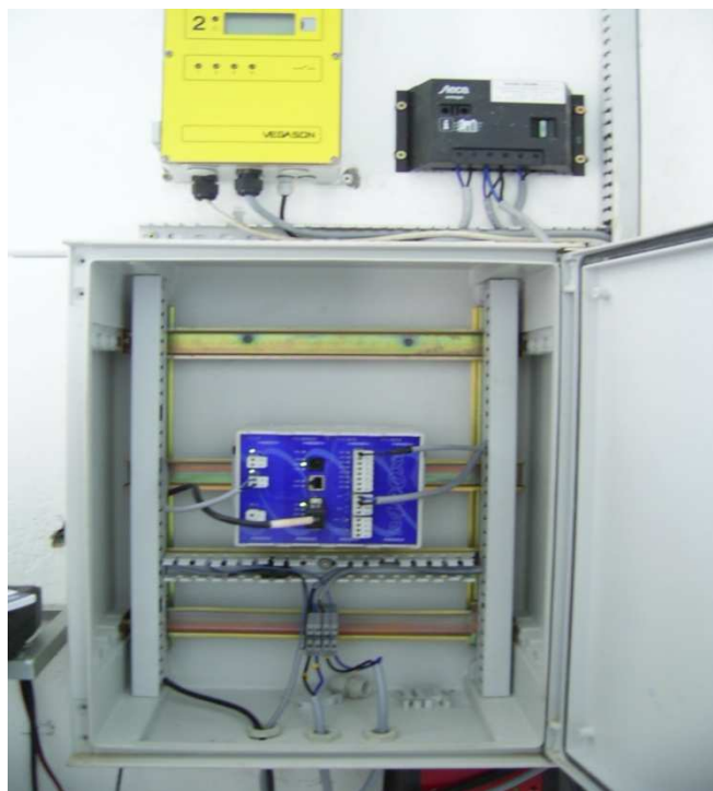
Photo 2 : Equipement de la station d'Ait Bouzguia
