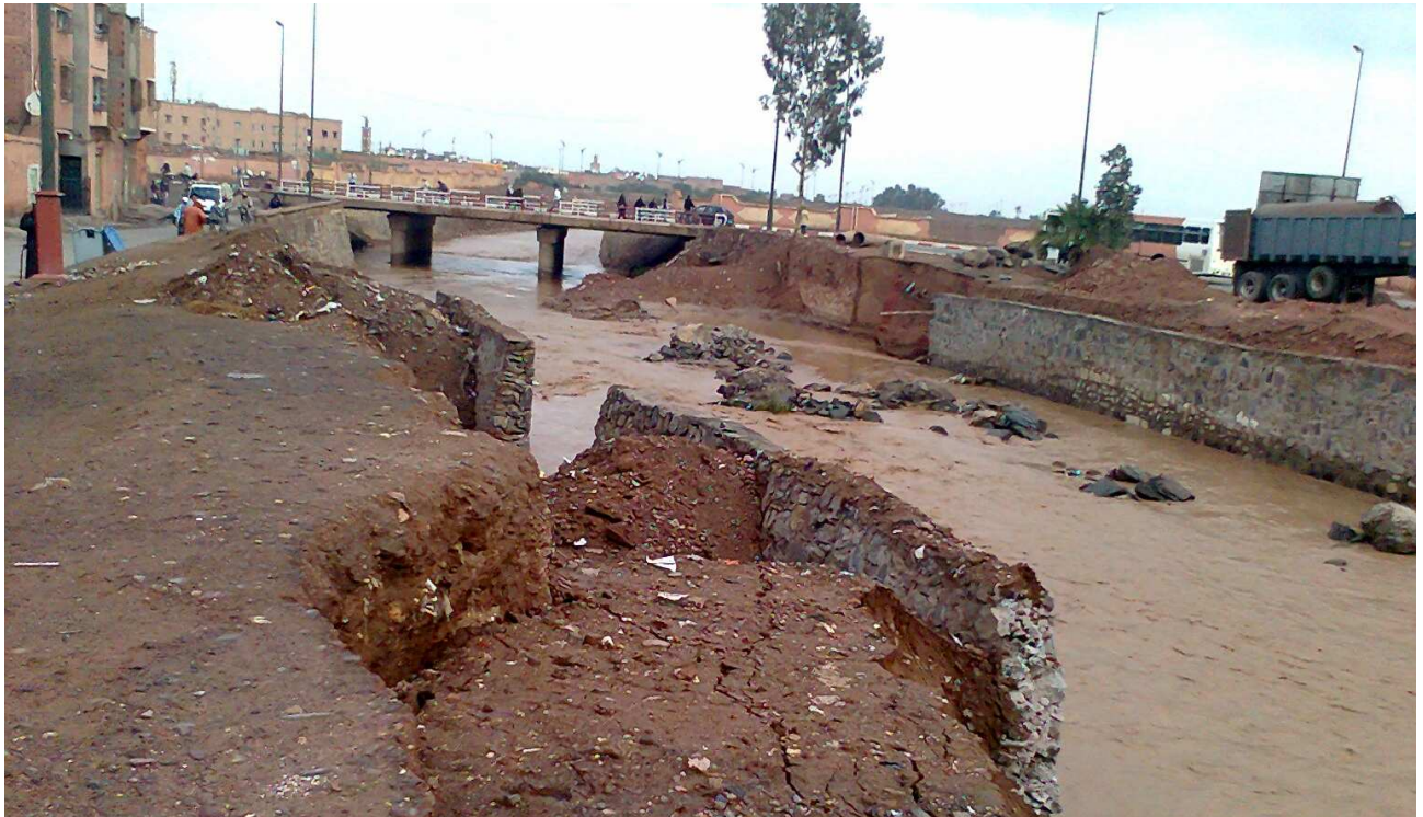
Photo 6 : Affouillement d'une berge de la rive gauche d'Issil et endommagement du mur de protection
