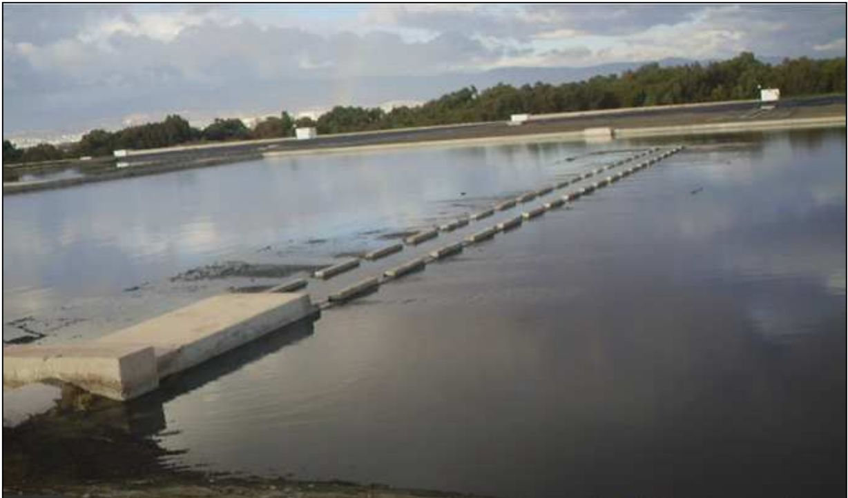
Figure 7 : Traitement secondaire : filtre à sable
