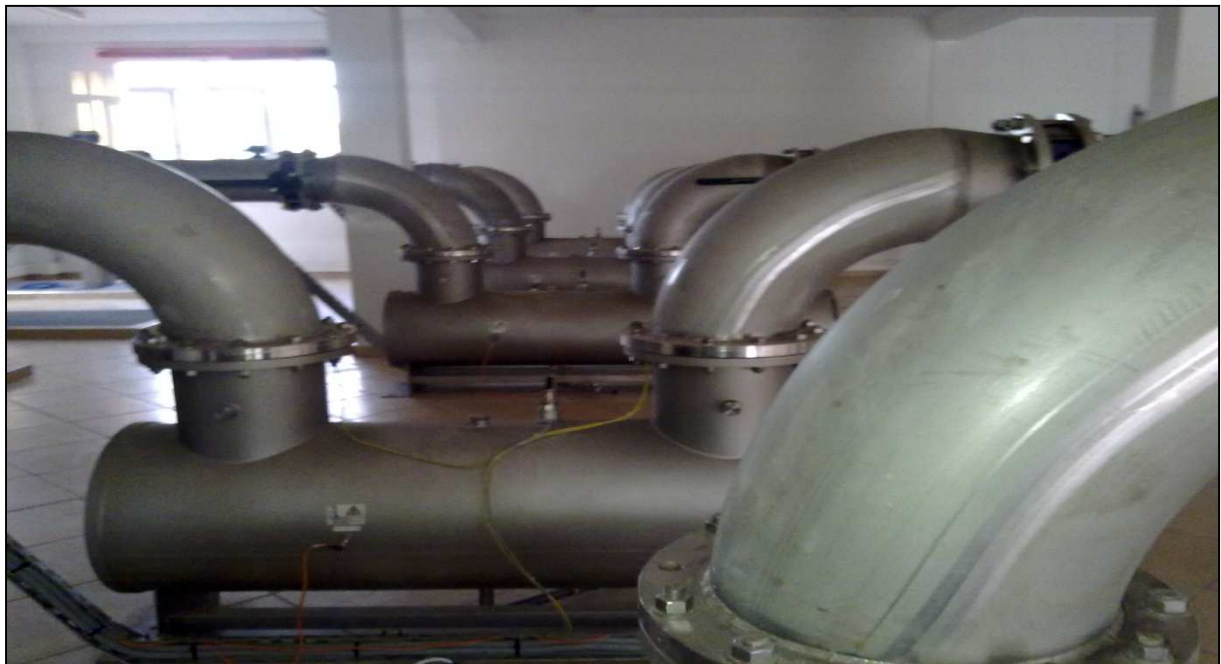
Figure 9 : Installation de désinfection par UV –traitement tertiaire
