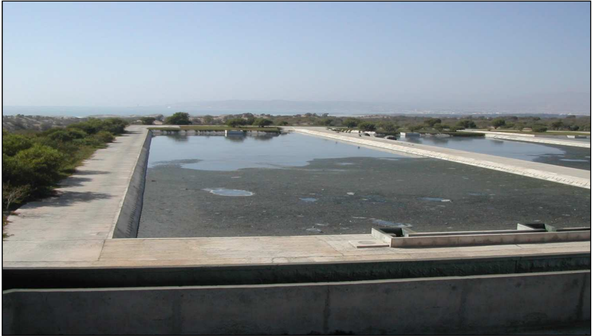
Figure 6 : Traitement primaire : décanteur
