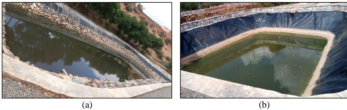
Figure 10 : (a) Bassin de lagunage ; (b) Bassin de stockage
