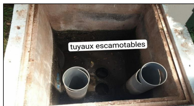
Figure 8 : Regard de répartition
