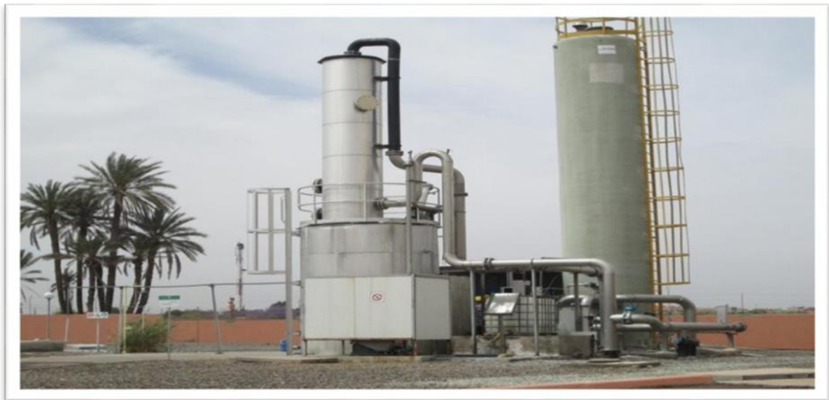
Photo 10: photo montrant un exemple de dissulfureuse de la STEP de Marrakech
