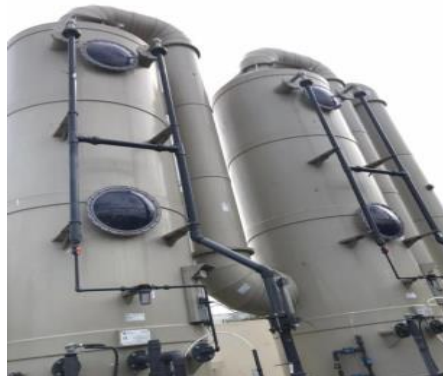
Figure 29: Réacteurs de désodorisation physico-chimique
