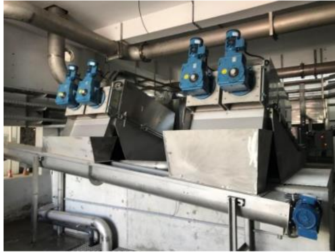
Figure 28: Presse à vis de Déshydratation des boues
