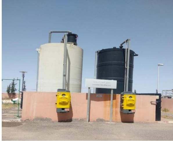
Figure 15 : Stockage des réactifs (eau javel)
