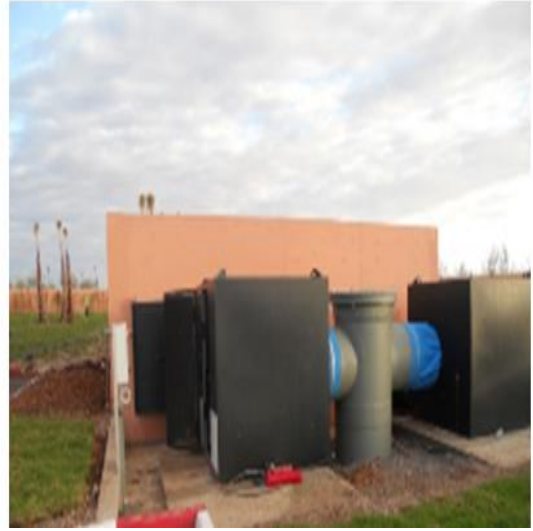
figure 27 : Désodorisation de file boue
