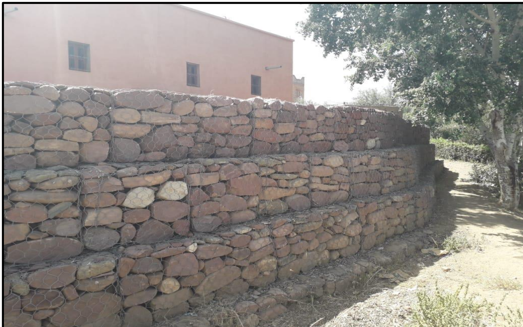
Figure 32 : exemple de mur de protection en gabion sur oued issil
