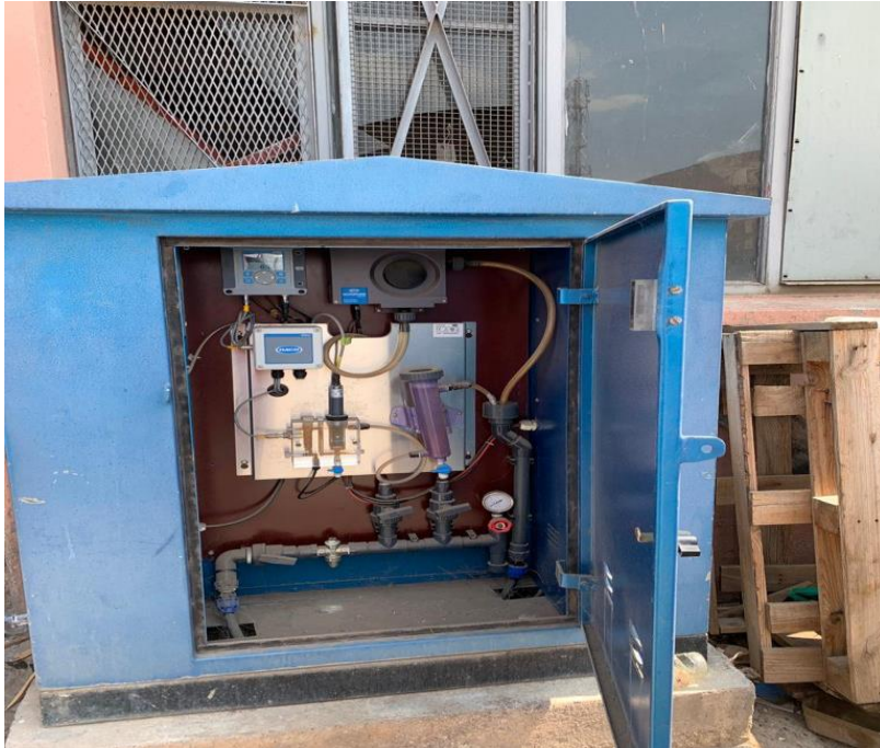
Figure 18: Armoire d'abri dans le point de qualité Arset Lmaach
