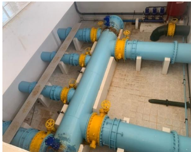
Figure 5: Réseau feeders dans les réservoirs (Sidi Moussa)
