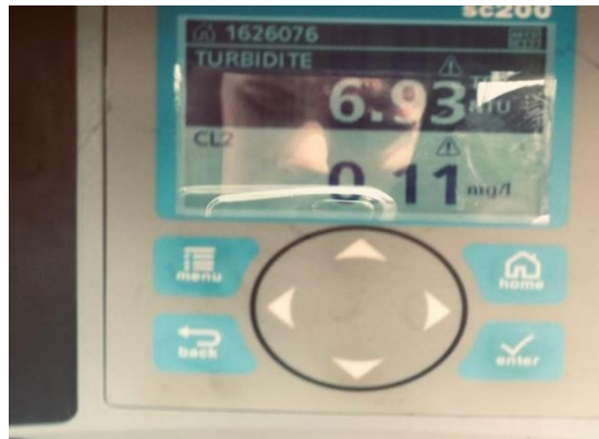
Figure 21: Valeurs de chlore et de turbidité avant maintenance
