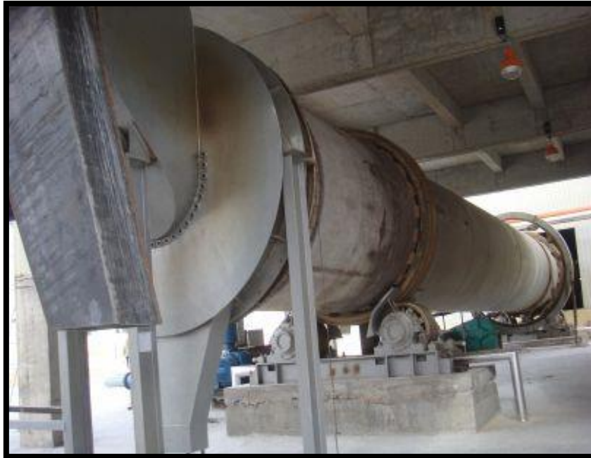
Figure 12 : Ventilateur du refroidisseur (documents internes de la-société).
