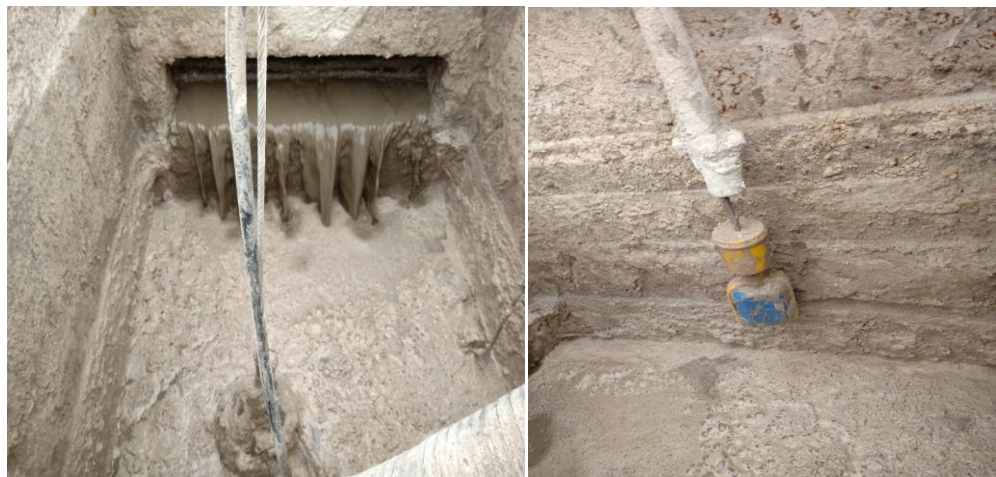
Figure 39 : Une goulotte avec flotteur à détecteur
