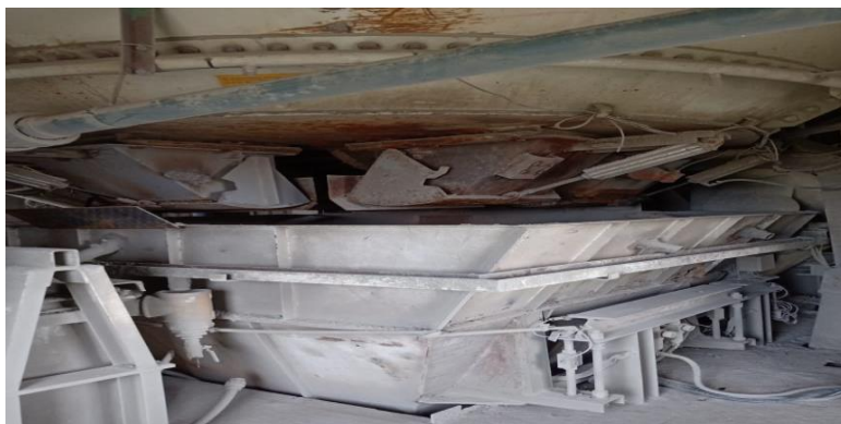
Figure 34 : peseur des granulats localisés dans la trémie secondaire
