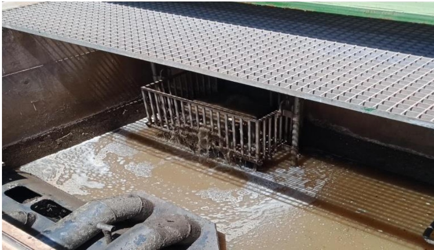
Figure12 : Dégrilleur de station Asselda
