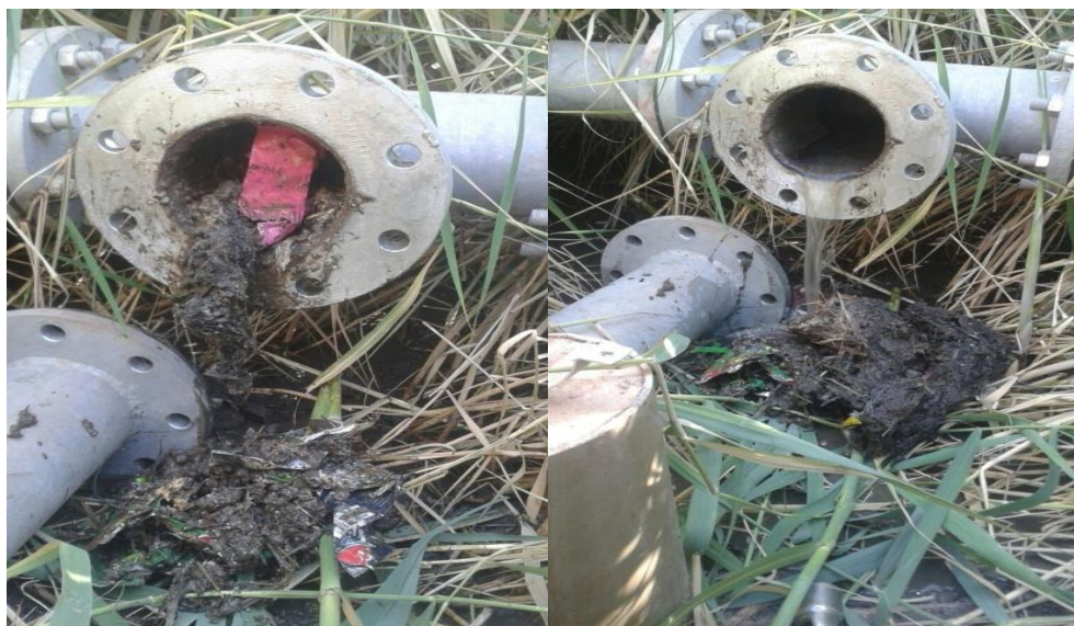
Figure 7 : Entretien au niveau des rampes d'alimentation de la surface d'un filtre
