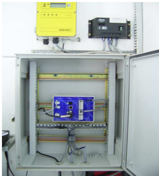
Photo 2 : Equipement de la station d'Ait Bouzguia
